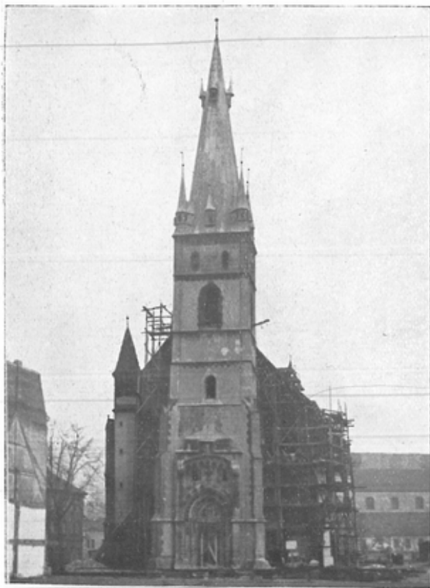
Ke konci války v roce 1945 byl bombardováním těžce poškozen arciděkanský chrám Nanebevzetí Panny Marie v Ústí nad Labem. Věž kostela se vychýlila v příčné ose o 1,40 m, byla 300 „betonovými injekcemi“ (vstříkování řídké malty pod tlakem 8 atmosfér) zachráněna. Opravu provedl stát.
