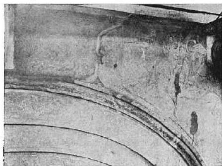
Stav sgrafit 1918 před opravou
