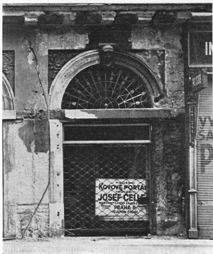
Platýz. Portál krámu po odkrytí.
