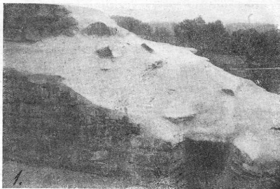
Hrad Okoř. Ukázka špatné konservace zříceniny. Nános cementové malty na zdivo.
