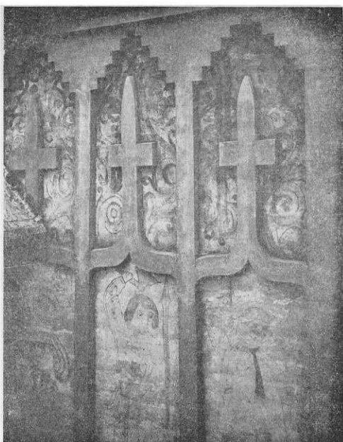
OBR. 62. DETAIL K OBR. 61. MALBY, ZACHOVALÉ V KONTURÁCH I BARVĚ (ORNAMENT NA ŽLUTÉ PŮDĚ ZELENÝ A ČERVENÝ, FIGURY PESTŘE) PONECHÁNY BEZ OMÝVÁNÍ A ZBYTEČNÉHO ČIŠTĚNÍ. JSOU VÝBORNĚ CHRÁNĚNY PROTI NEPOHODĚ ZAKŘIVENOU ÚZKOU ULIČKOU.
